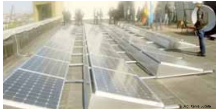
Die Solarmodule im Sonnenlicht.
