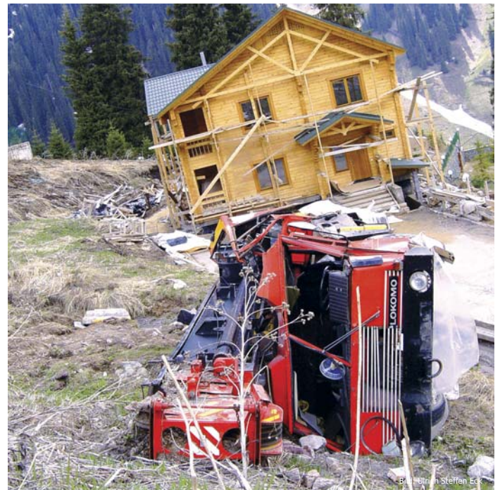
Höhenflug am Bau endet mit Kran-Purzelbaum: Im Märchen wäre die Rede vom Berg, der den lästigen Baulöwen abschüttelt.
