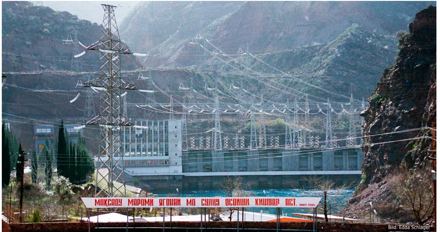
Das Wasserkraftwerk Nurek in Tadschikistan. Die einen brauchen das Wasser im Winter zur Energieerzeugung, die anderen im Sommer zur Bewässerung.
