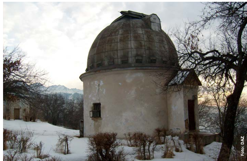
Das Teleskophäuschen hat schon mal bessere Tage gesehen.
