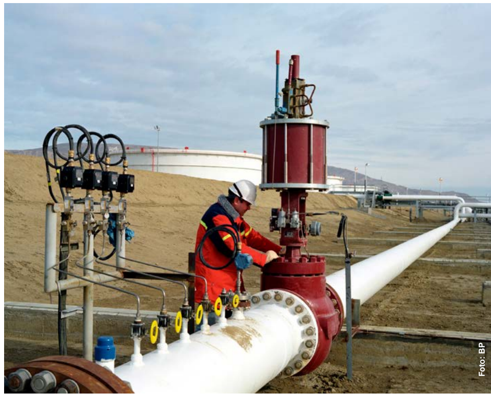
Deutschland bezieht ein Fünftel seines Ölbedarfs aus der Druschba-Pipeline.
