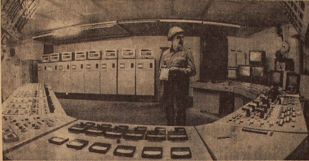
Eine der größten Weißblechabteilungen des Zweigs — die im Karagandaer Hüttenwerk — wird mit der Erreichung ihrer projektierten Kapazität die Produktion von Feinsblech für die Konservenindustrie im Landesmaßstab doppelt erhöhen. Diese Produktionsstätte ist einzigartig. Alle Baugruppen und Aggregate des Walzwerks arbeiten im automatischen Regime, was den Prozeß des Walzens von Blechtafeln mit 0,03 Millimeter Präzision regulieren hilft.
