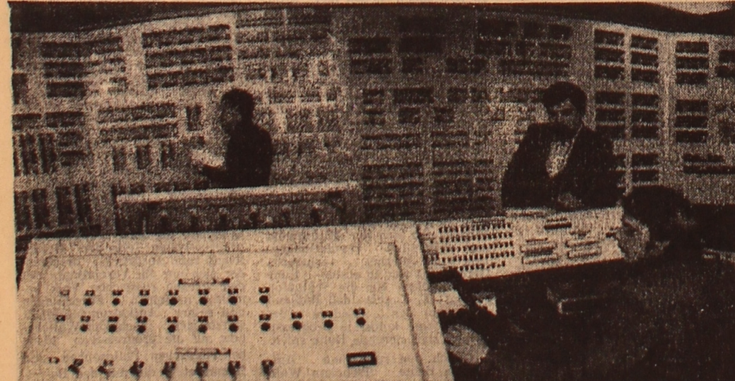
In der Zeltingrader Produktionsvereinigung für Gen-Zucht wird die Instandsetzung des automatisierten Systems der Prozesssteuerung der Geflügelproduktion in Komplexen beendet. An der Montage des Dispa-
