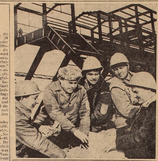
Das Anlaufobjekt des Planjahres — die Aufbereitungsabrik des Ostkasachstaner Kupfer- und Chemiekombinats — ist ein Schwerpunktbauvorhaben der Bunimlurgie Kasachstans. Die Bauarbeiter haben sich verpflichtet, dieses Objekt im dritten Quartal des laufenden Jahres dem Betrieb zu übergeben. Die Kollektiv der Trüste „Chimstroj“ und „Alfawinsedro“ haben bereits viel geleistet: Zehn Produktionsgebäude aus Metall und Beton sind fast fertiggestellt.
