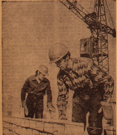
Zu einer der besten Brigaden der Stadt Semipalinsk zählt das Kollektiv, das von Wladimir Steigert geleitet wird. Diese Maurerbrigade hat sich ihren guten Ruf durch die hohe Qualität der Arbeit und durch den Fleiß der Brigademitglieder erworben. Jedes Bauobjekt wird von diesem Kollektiv mit höchster Qualität und vorfristig bereitgestellt. Wladimir Steigert hat den Beruf des Maurers nicht von ungefähr gewählt. Darauf hatten einen bestimmten Einfluß sein Vater und Bruder gehabt, die auf den nebenliegenden Bauobjekten tätig sind.
