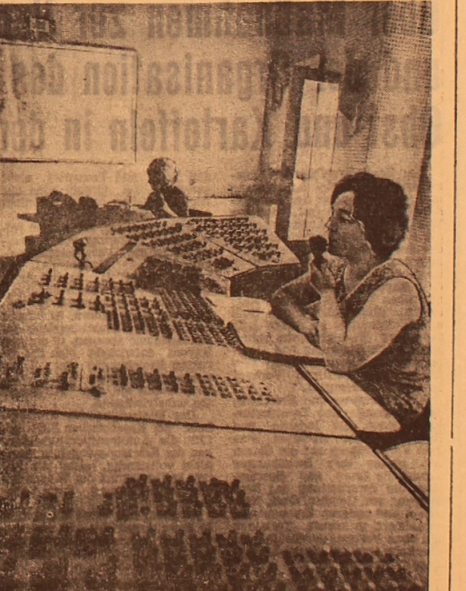
Steuerpult der Elektrozentrale im Tagebau „Bogatyr“.
