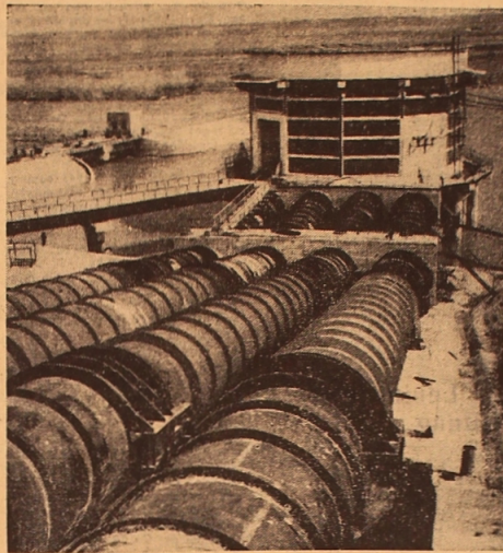
Die Pumpstation Nr. 1 ist die komplizierteste hydrotechnische Anlage am Steppenkanal Irtysch-Karaganda und besitzt eine Leistungsfähigkeit von 75 Kubikmeter Wasser pro Sekunde. Im Jahre 1967 forderte die Station die ersten Kubikmeter Wasser aus der Wasserreplantanlage in künstliche Bett des Kanals.
