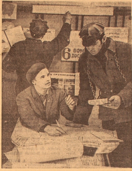
GEBIET SWERDLOWSK. Die Bauarbeiter des 6. Hochovens des Nischni Tagiler Hüttenkombinats schätzen buchstäblich jede Sekunde. In hohem Tempo errichten sie den Herd, legen Rohrleitungen, montieren die Mechanismen des Schmelzpfannes. Immer näher rückt der Tag heran, da der Hochofengigant die erste Schmelze liefern wird. UNSER BILD: Die laufende Nummer der Wandzeitung des Komsomols am Bau des 6. Hochovens wird vorbereitet. Links — der Leiter des Stabs G. Golowkow, rechts — der Montagarbeiter S. Jerschow. Foto: A. Solnikow (TASS)
