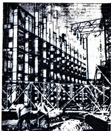
KARAKALPAKISCHE ASSR. Am Wärmekraftwerk Tschitachsch ist die Errichtung der 3. Baufolge in vollem Gange. Im Oktober dieses Jahres soll der 1. Stromblock, dessen Kapazität 100 000 Kilowatt ausmacht, in Betrieb genommen werden. Nach Abschluß des Baus der 3. Baufolge wird die gesamte Kapazität des Wärmekraftwerks 600 000 Kilowatt betragen, was die Stromlieferung in das Gebiet Choresm um vieles vergrößern wird.
