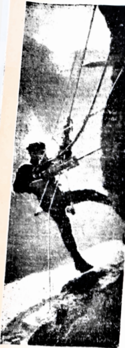
Am Fluß Naryn baut man das Toktogulsker Wasserkraftwerk, eines der größten in Mittelasien. Seine Leistung soll 1,2 Millionen Kilowatt betragen.
