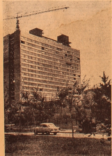
Auf dem Leninprospekt in Moskau wird ein 17 geschossiges Hotel des Zentralen Unionsgewerkschaftsrats errichtet. Es wird 1.000 Ein- und Zweibettzimmer für die Gäste der Hauptstadt haben. In allen Nummern wird die Lüftung und die Luft-Klimatisierung eingeführt. Im Erdgeschloß des Hauses wird ein Restaurant mit 450 Plätzen untergebracht sein. Neben dem Hotel ist laut Projekt ein Parkplatz für Autos geplant. UNSER BILD: Der Bau des neuen Hotels. Foto: APN
